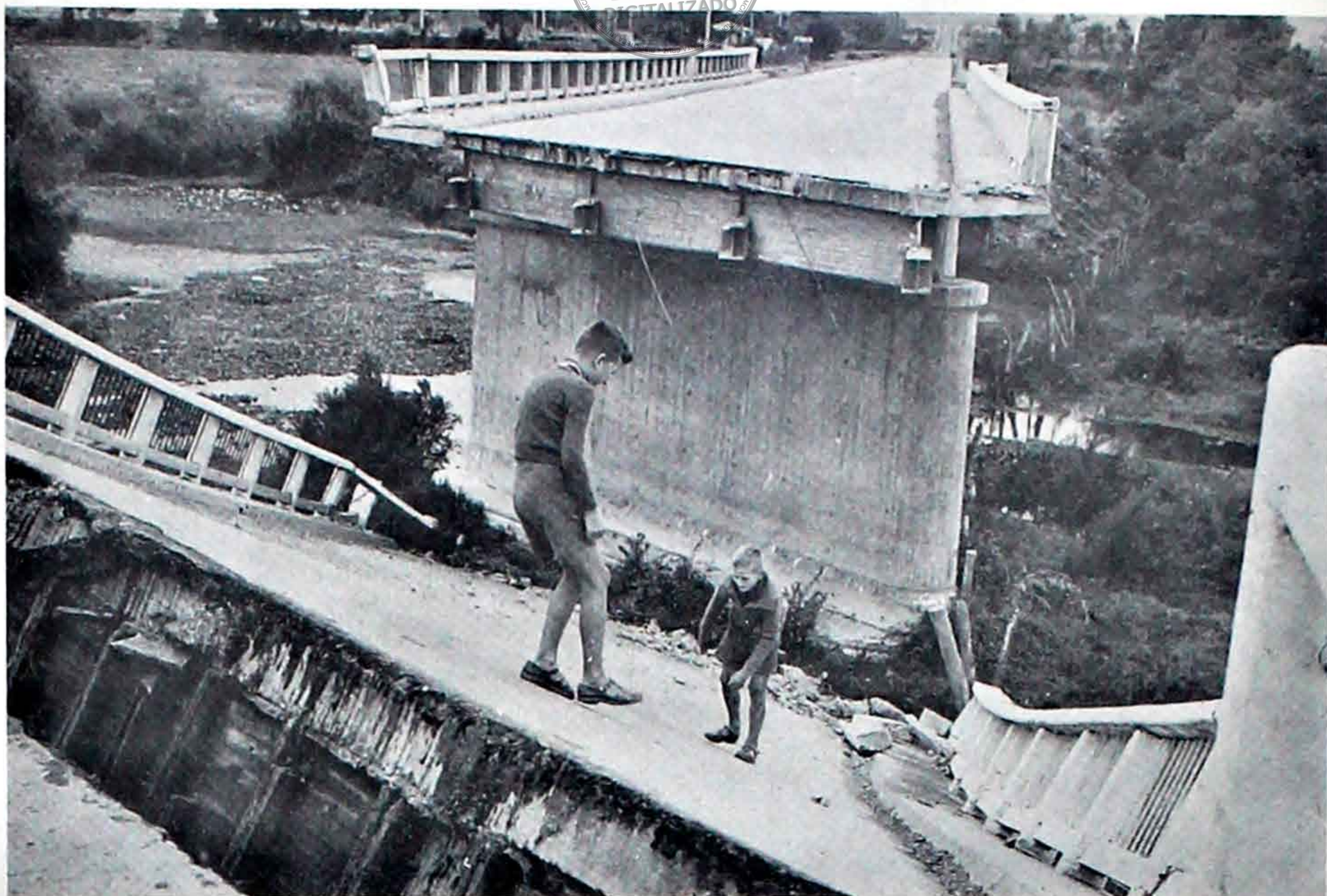
Enormes fueron los daños sufridos por varias regiones de Chile durante el terremoto que asoló a este país el 28 de marzo pasado. Esta fotografía da una idea de la violencia del sismo. Se trata del puente Pullalli, en la Carretera Panamericana Norte, frente al desvío a Zapallar, que tiene destruido un tramo completo, el cual cayó al estero del mismo nombre, a 10 metros de profundidad. La ruptura de este tramo obligó a los vehículos a realizar grandes rodeos para llegar a destino.
